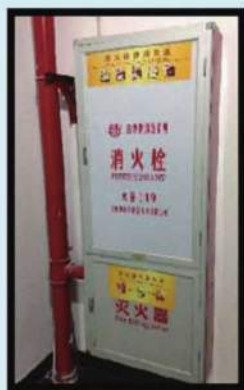
消火栓、灭火器
